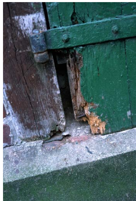
Abb. 17: Rattenschaden an Speichertür, Quelle: JKI
